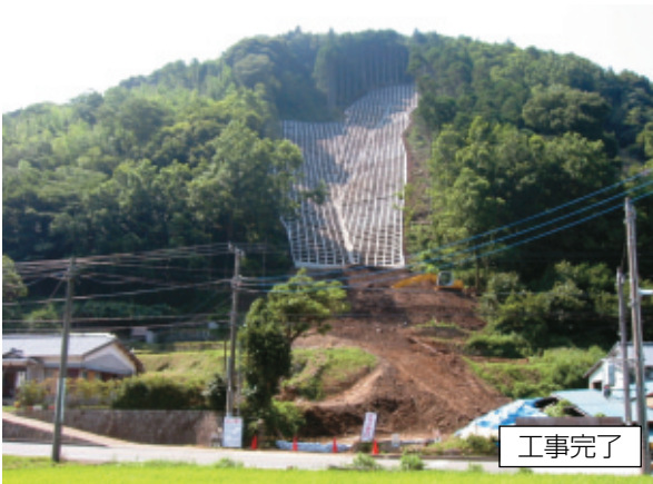
▲H16年の台風22号により山腹崩壊が発生し、災害関連緊急治山事業により迅速な対応を図った伊豆市浜井場の状況
