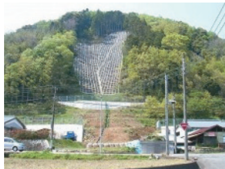
▲写真-2 緊急治山事業施行地 伊豆市上船原 現況 (H19.4)
