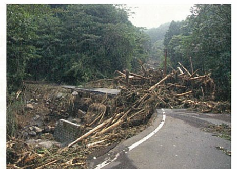
▲広域基幹林道：山頂方向からの崩落
