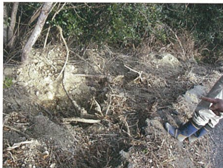
▲イノシシに荒らされた農道及びその法面
