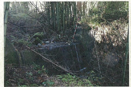
▲写真3 谷止工：左岸袖上部の欠落状況
