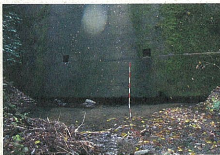
▲写真1 谷止工：洗堀の状況
