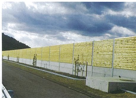
▲新東名高速道路の木製遮音壁（掛川市）
