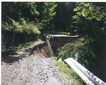
▲林道 青崩線災害現場
