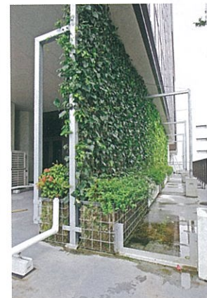
▲自立型壁面緑化施設
