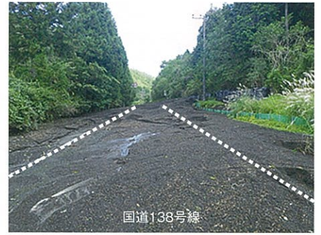
▲国道138号への土砂流出状況
