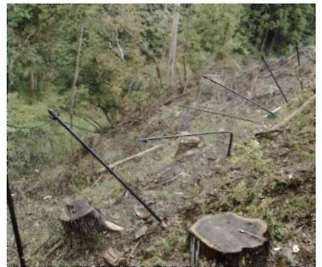
▲落石で破損した防護柵
