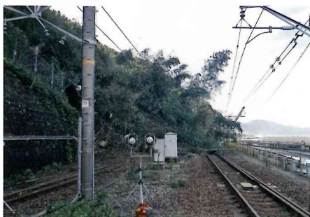
図-2 東海道本線土砂流入状況
