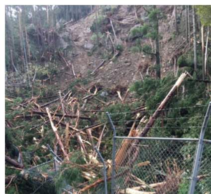
▲被災時の隧道入口付近山林法面状況
