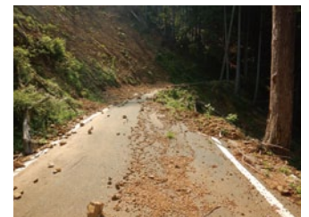
▲林道池線復旧作業に着手できていない状況
