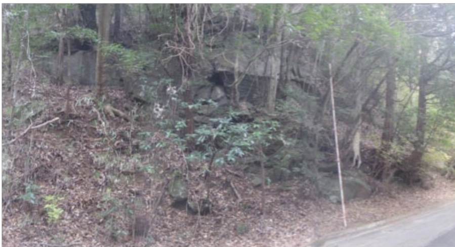
▲道路のり面に点在する転石状況
