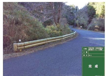
▲木製ガードレール
