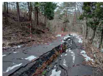
▲石川県穴水町の林道の地震による被害状況
